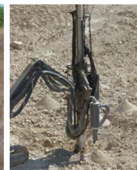
Récupérateur de poussières sur la foreuse
